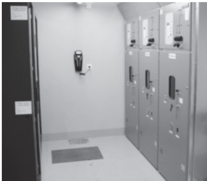
Neue Mittelspannungsanlage bei der Trafostation Tramstrasse.
