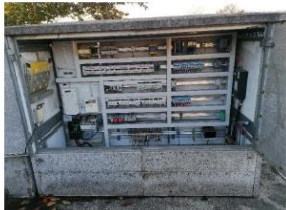
Pumpwerk Übrig, Ersatz EMSRL
