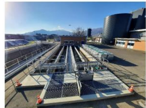
Neue, SUVA-konforme Geländer
