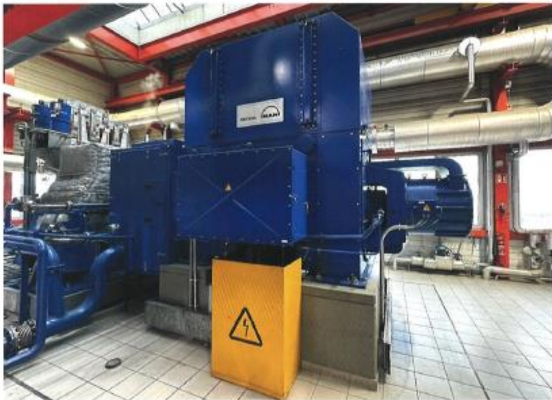
Revidierter Generator mit 10 MW Leistung
