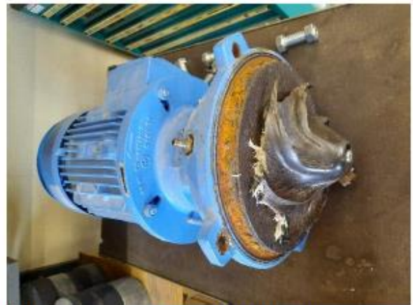
Abnutzung Laufrad des Mixers Rechengut-Waschpresse
