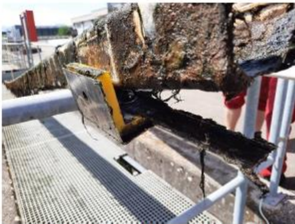
Gerissener Räumerbalken im Nachklärbecken
