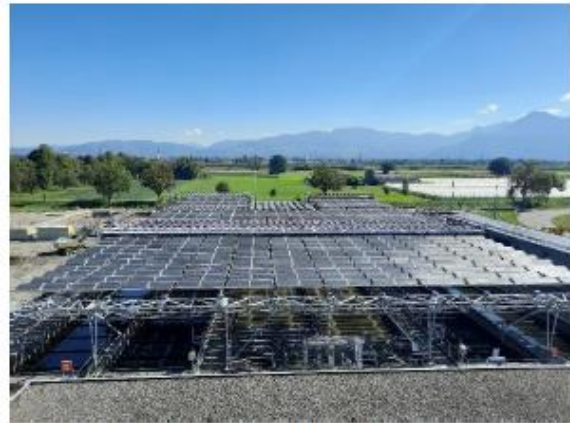
Faltdach ausgefahren, 1280 Module produzieren Strom
