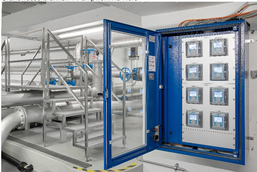
Messverstärkerschrank – Wasserqualitätsstation Pumpwerk Au Nord
