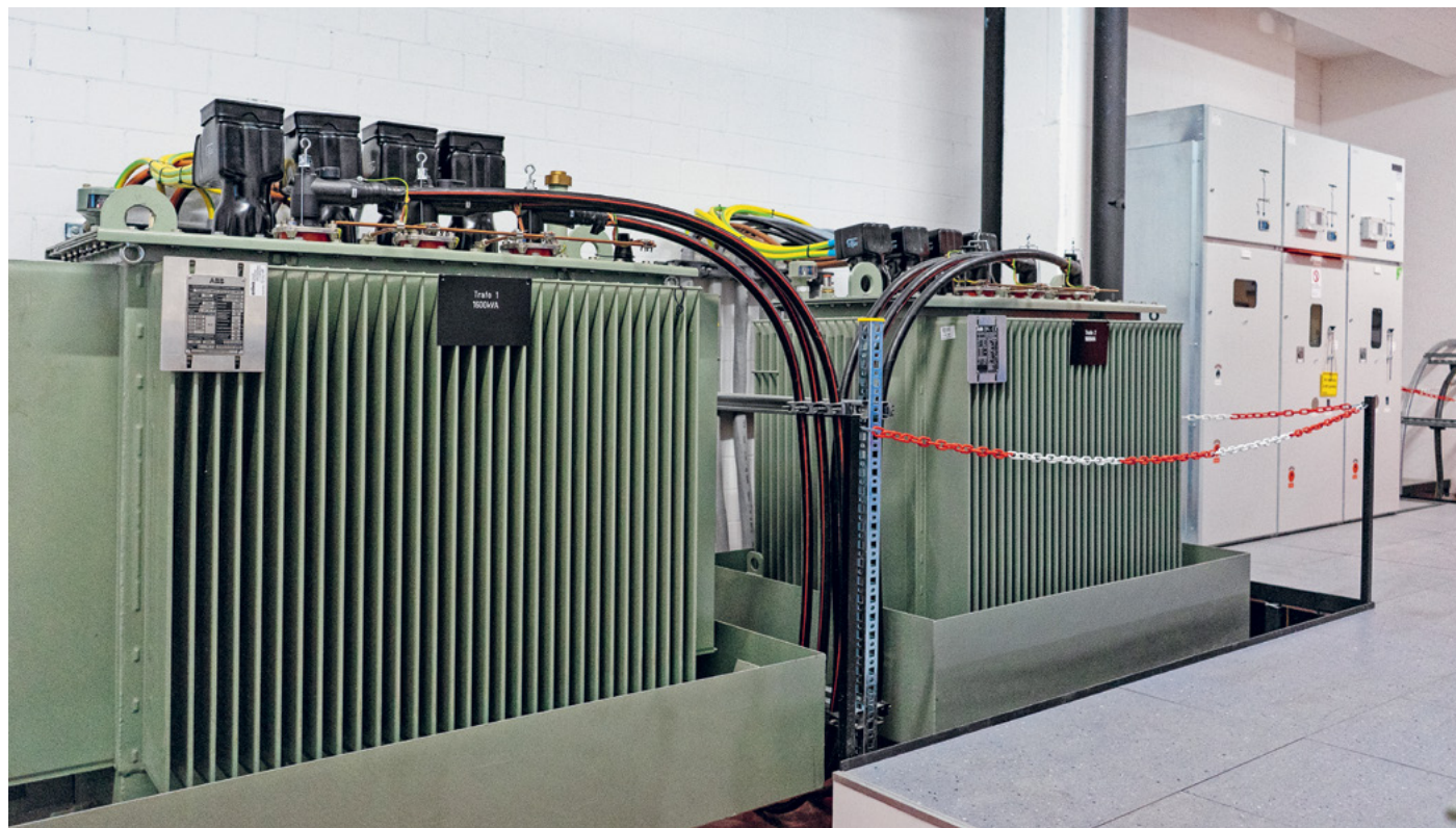
Trafostation Gustav Spiess AG
