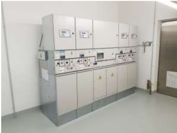
Mittelschaltanlage PW Au-Nord I
