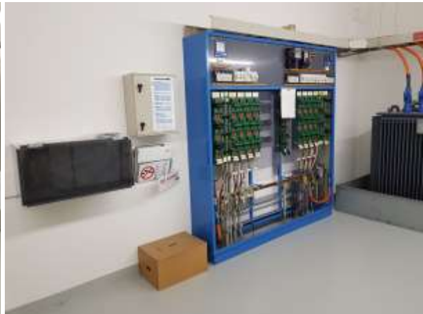
Mittelschaltanlage PQW Au-Nord II
