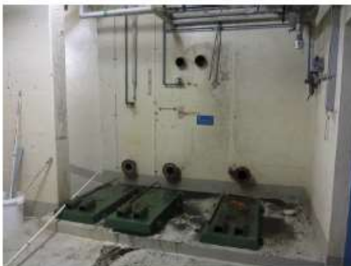
Hier standen einmal die alten Aufheizpumpen
