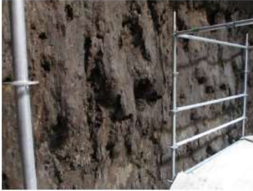
Ablagerungen an der FR-Wand
