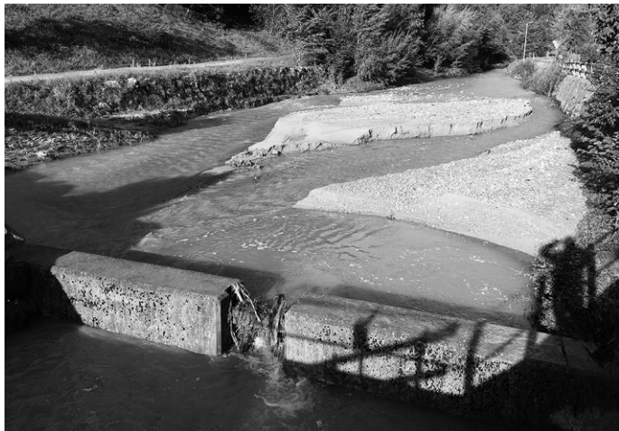
Voller Schlossbruggsämmler nach dem Hochwasser.
