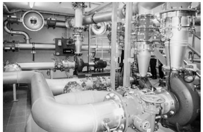
Rohrkeller Pumpwerk Viscose, Widnau
