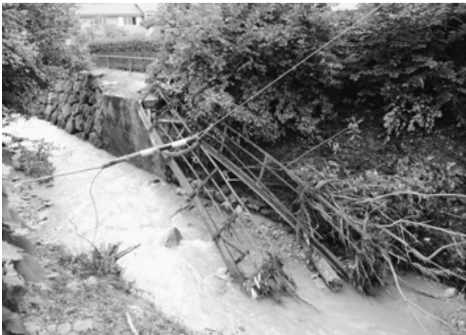
Büntsteg nach dem Hochwasser 2014
